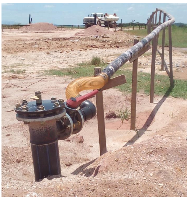
Figura 5. Sistema de captação de gases de um aterro sanitário.
