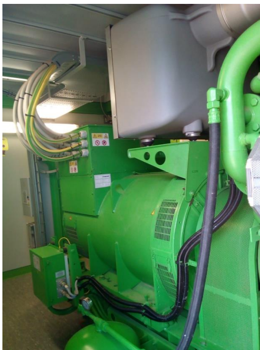
Figura 8. Motor para geração energia a partir do biogás do CTR Macaé.
