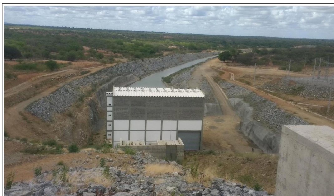
Figura 14. Estação de bombeamento do PISF.
