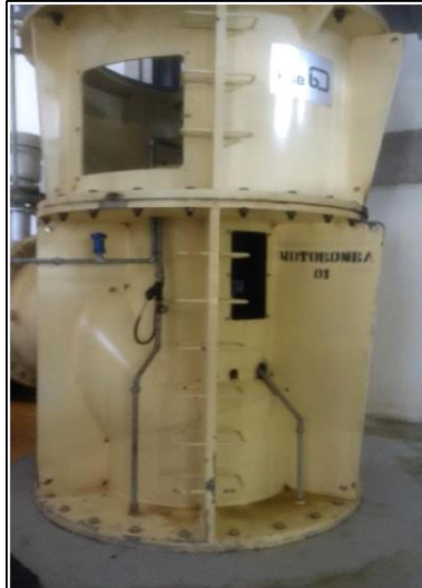
Figura 15. Motobomba instalada nas EB's. Fonte: Acervo do autor.
