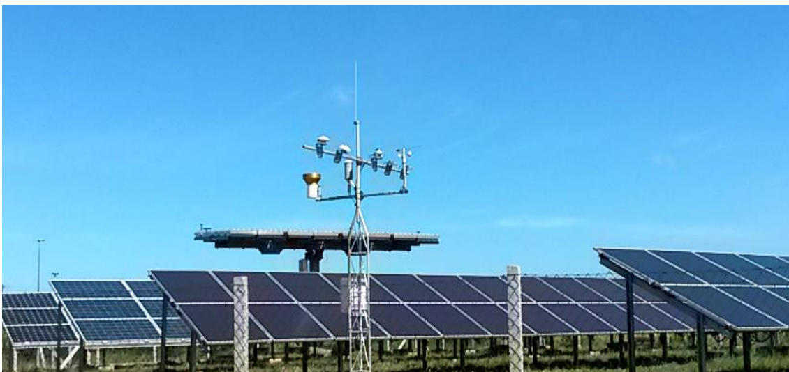
Figura 100: Vista parcial do Pátio de Pesquisa de Geração Solar FV - Enel/IFF Fonte: do autor
