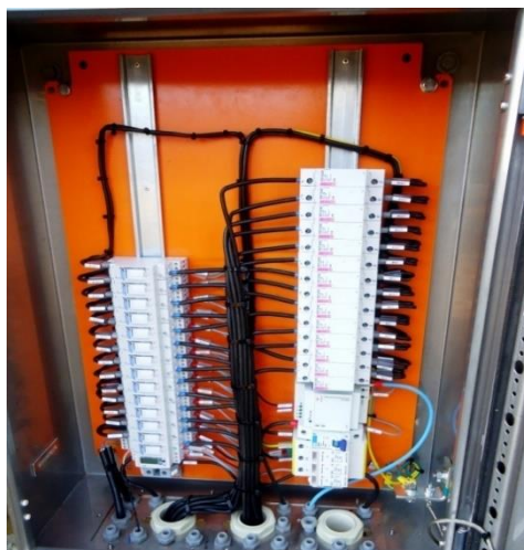
Figura 113: Caixa de ligação instalada de strings no Pátio geração FV Fonte: imagem do autor (2016)
